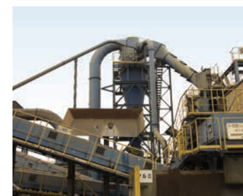
ギロチン設備、シュレッダー設備、プレス設備を利用し、スクラップの加工、選別、転炉挿入作業を一貫して行っています。
